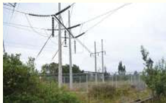
Se creó el Sistema Nacional Interconectado Foto: INECEL
