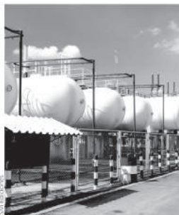
Planta de gas natural.
